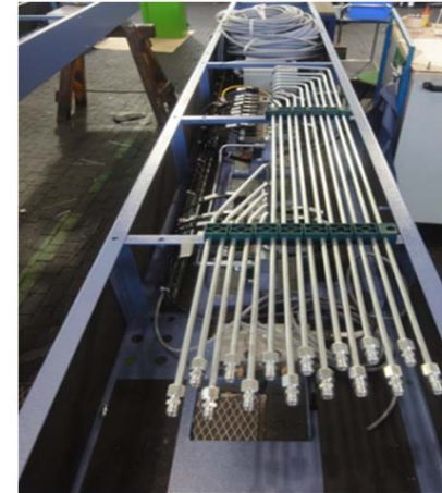
Bild 11: Die Zuleitungen für Hydraulik, Pneumatik und Schmierung sind in Installationsprofilen untergebracht.
