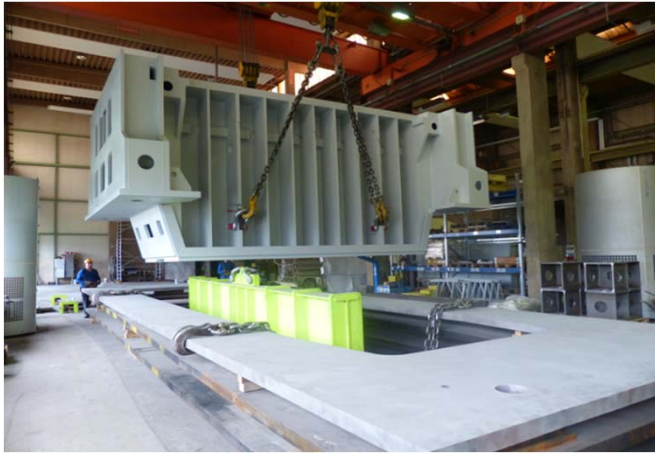
Bild 5: Koloss perfekt im Griff: Das Handling der 156-Tonnen schweren Komponenten war Maßarbeit.
