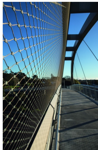
Bild 7: Edelstahlgewebe kommt nicht nur aus dekorativen Gründen zum Einsatz, sondern auch als leistungsfähige Absturzsicherung.
