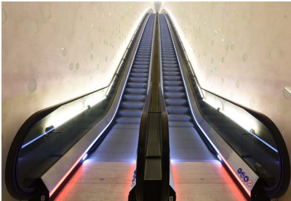
Bild 3: 80 Meter misst die längste Fahrtreppe Westeuropas aus Edelstahl Rostfrei in Hamburgs Elbphilharmonie.
