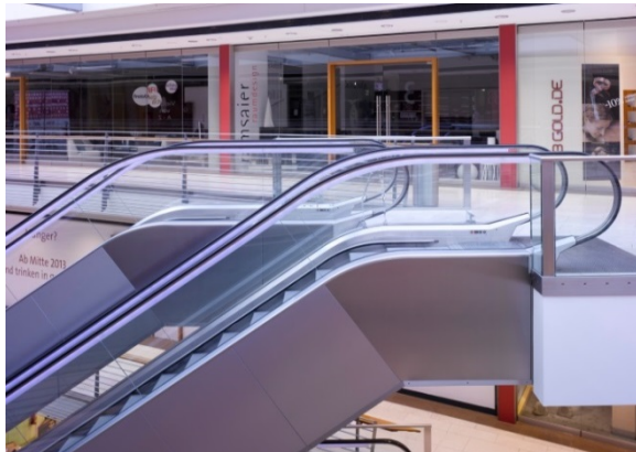
Bild 7: LED-beleuchtete Handläufe oder Stufenbänder sorgen an Rolltreppen aus nichtrostendem Stahl für zusätzliche Lichtblicke.
