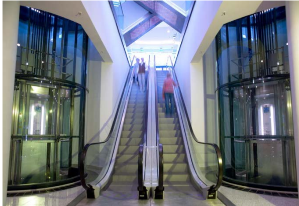
Bild 1: Rolltreppen aus Edelstahl Rostfrei sind weltweit rund um die Uhr im Einsatz.
