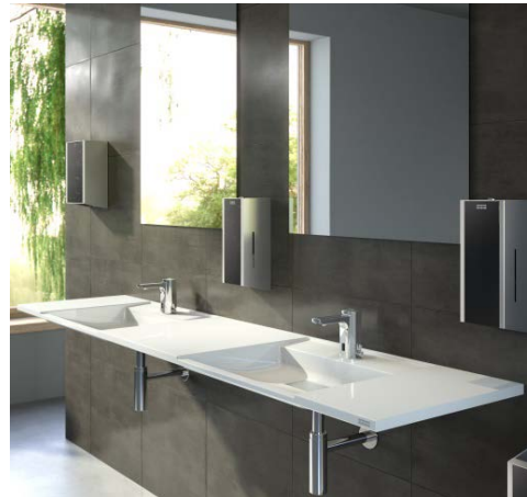
Bild 8: Im Waschtisch integrierte Auslaufrohre aus Edelstahl Rostfrei sind dauerhaft verschleiß- und korrosionsbeständig.
