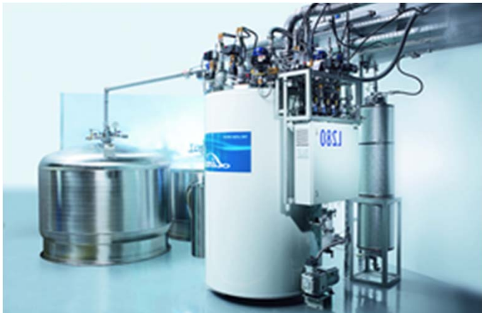
Bild 3: Kryotechnik zur Helium-Verflüssigung: Plattenwärmetauscher in der Coldbox kühlen das Edelgas bei -180 Grad Celsius ab.
