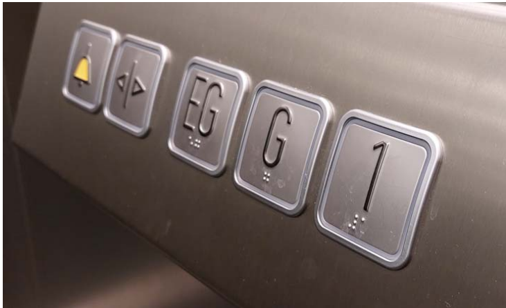
Bild 1: Pflegeleicht und langlebig fügen sich klassisch zeitlos und bedarfsgerecht mit Brailleschrift gestaltete Aufzugtableaus harmonisch in nahezu jedes Gebäudekonzept ein.
