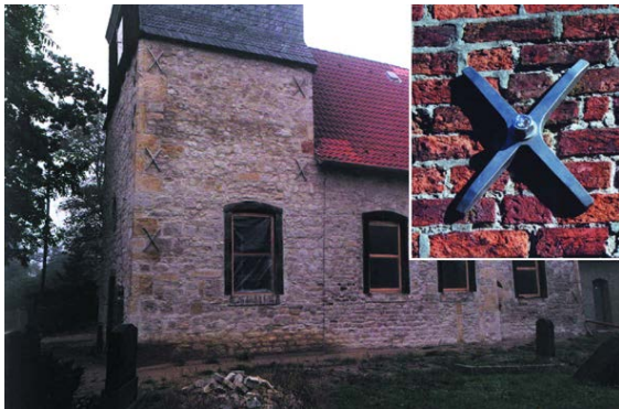
Bild 4: Stabilisierung der Wände mit Zugstangen aus Edelstahl Rostfrei mit außen unterlegten Andreaskreuzen
