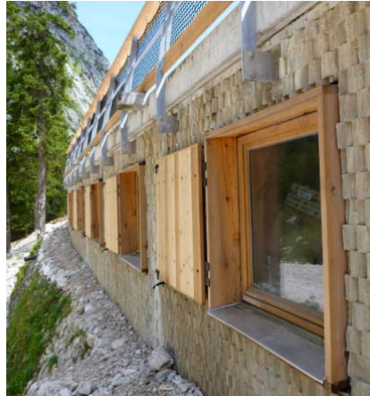
Bild 6: Fenster- und Sockelanschlussbleche aus matt patiniertem Edelstahl greifen in der Höllentalangerhütte die Tonigkeit der alpinen Landschaft auf.
