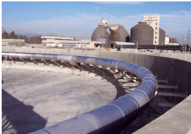
Bild 3: Komponenten aus Edelstahl Rostfrei sind in den mechanischen und chemisch-physikalischen Verfahrensstufen in Kläranlagen etablierter Standard.
