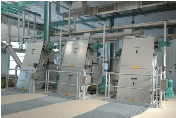
Bild 5: In der Ab- und Prozesswasserreinigung gewährleisten robuste Raket aus Edelstahl Rostfrei die erforderliche Langlebigkeit.
