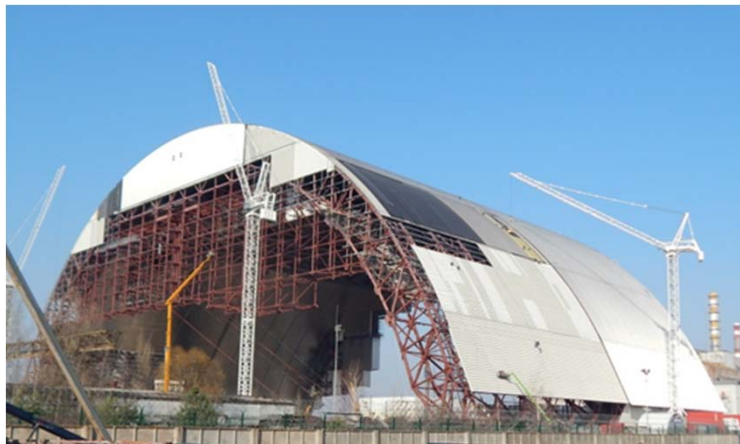
Bild 1: Mit Hilfe einer 86.000 Quadratmeter großen bogenförmigen Schutzhülle aus Edelstahl Rostfrei soll Tschernobyl wieder in einen ökologisch sicheren Zustand überführt werden.
