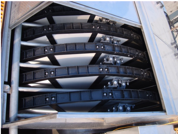
Bild 3: Bei der Abwasseraufbereitung werden Scheibenfilter aus Edelstahl Rostfrei zur Mikrosiebung eingesetzt.
