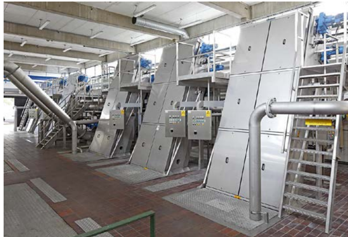
Bild 2: Umlaufrechen aus nichtrostendem Stahl auf einer Großkläranlage in Dänemark
