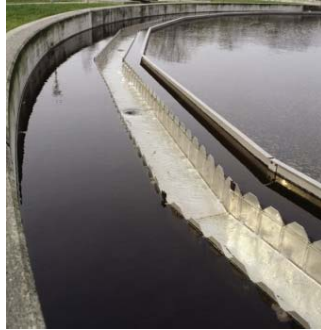
Bild 2: Korrosionsbeständig – Überlaufrinne einer Kläranlage
