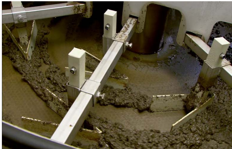
Bild 3: Der im Bodenbereich des Eindickers angesammelte Schlamm wird durch Schilde aus nichtrostendem Edelstahl abgezogen und über Edelstahlrohre zur nächsten Behandlungsstation befördert.
