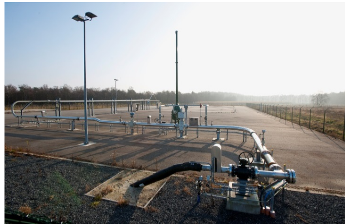
Bild 9: Ob als Förderleitung oder Transportsystem für korrosives Öl und Gas: Hochleistungsrohre für Nieder-, Mittel- oder Hochdruckanwendungen aus Edelstahl Rostfrei gewährleisten die geforderten Standzeiten.
