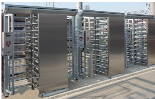
Bild 4: Hohe Portalkreuze aus Edelstahl Rostfrei verbinden an Eingängen mit geringem bis mittlerem Besucherandrang angepasste Frequenz mit Komfort.
